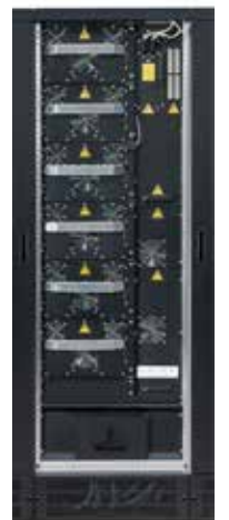
Vista interna dell'unità di potenza
